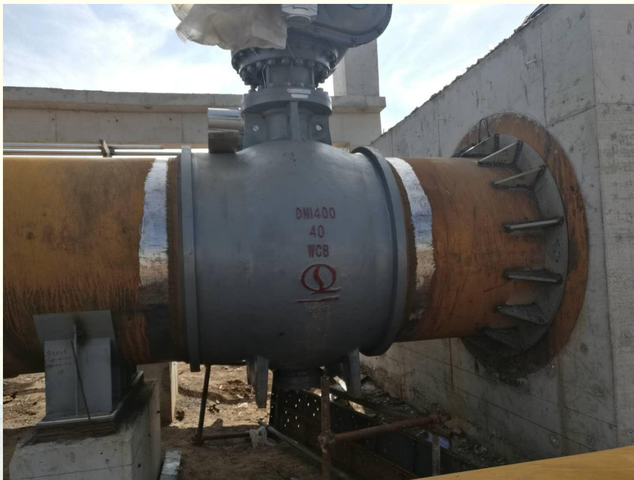
大唐国际张家口发电厂热网水系统
