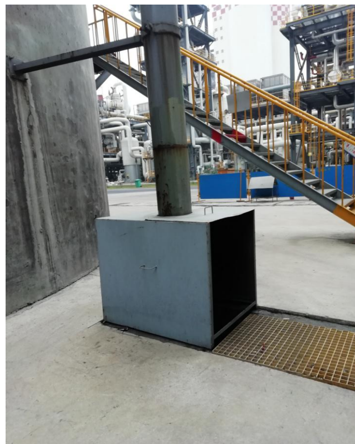
煤浆槽大颗粒排放口
