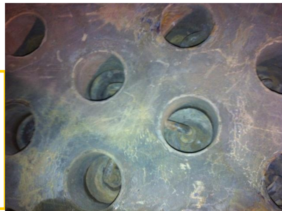
改进后的水洗塔内部情况
