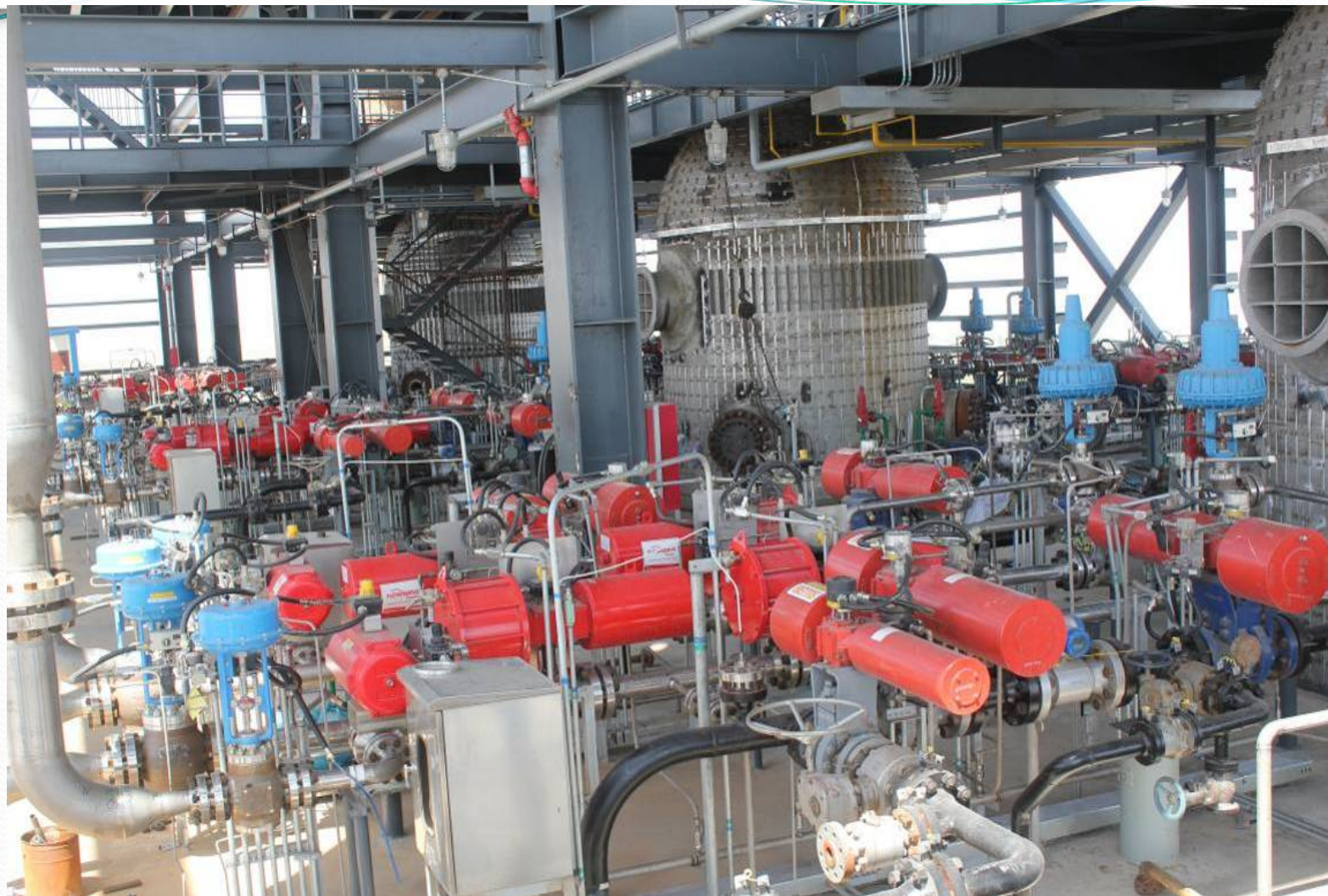
气化炉给料部分阀门组
