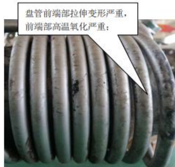
1172-J-3001D 检修前照片
