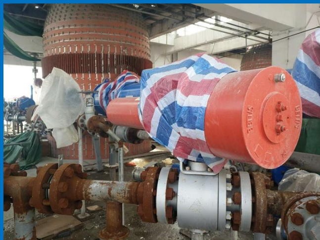
内蒙古汇能 煤浆循环管线回流调节阀 5.4MPa带压联投 2020年
