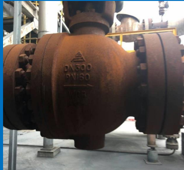
诚志（南京）清洁能源 激冷水泵切断阀 2012年5月
