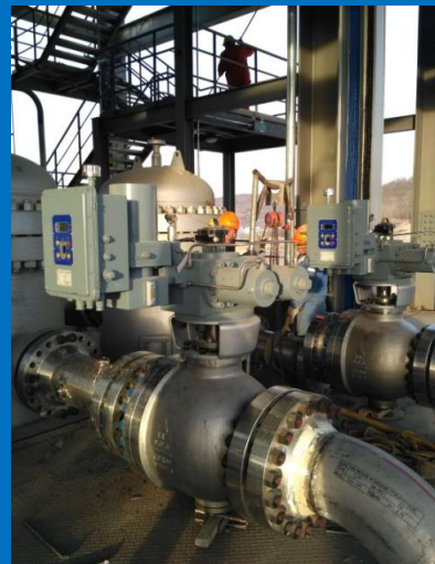
延长能化 电液联动激冷水泵切断阀 2018年9月
