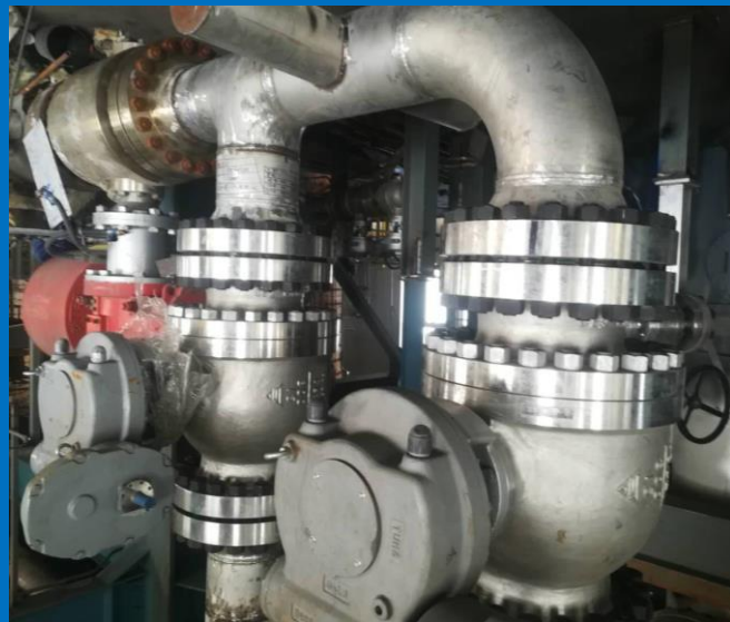
中石化宁夏长城能源 激冷水泵切断阀 2018年5月
