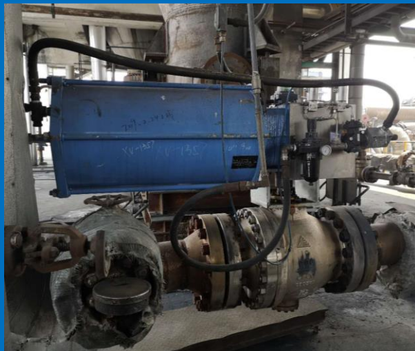
兖矿国宏 黑水灰水切断阀 2015年8月
