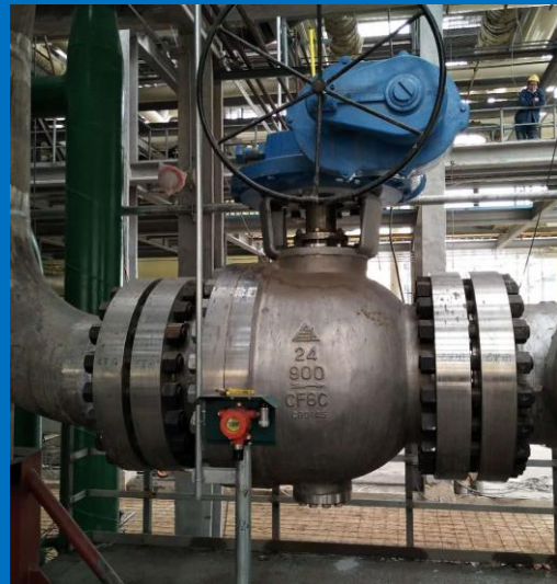
宁夏宝丰能源合成装置 脱硫槽进出口手阀 2020年5月
