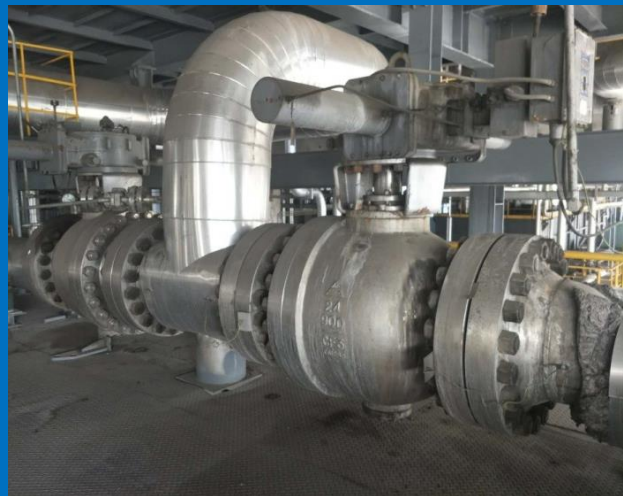
华鲁恒升 电液联动激冷水泵切断球阀 2017年9月
