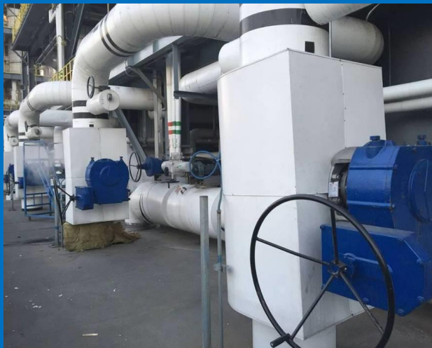
万华化学集团 激冷水泵切断阀 2015年9月
