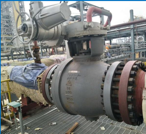
宁夏宝丰能源合成装置 水煤气进变换界区电动阀 2020年5月
