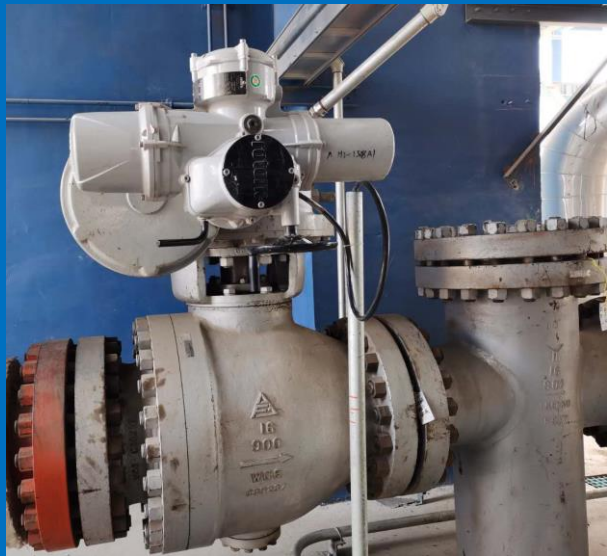
金城石化 激冷水泵切断阀 2019年
