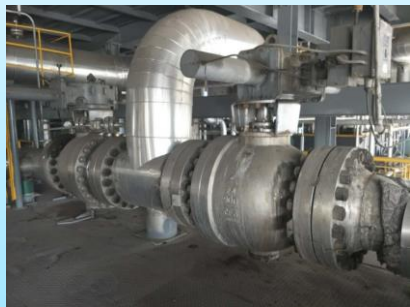
激冷水泵切断阀
