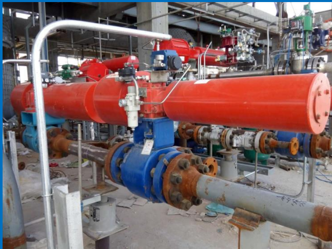
华鲁恒升 煤浆循环管线回流调节阀 5.4MPa带压联投 2017年9月
