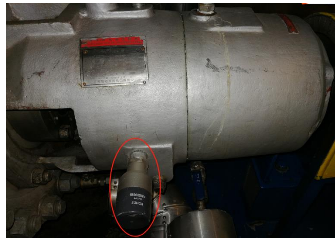
黑水循环泵运行状态实时监测系统
