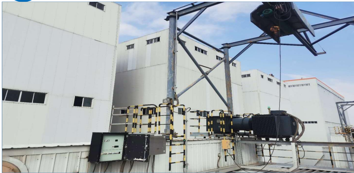
一期三台220t/h循环流化床锅炉
