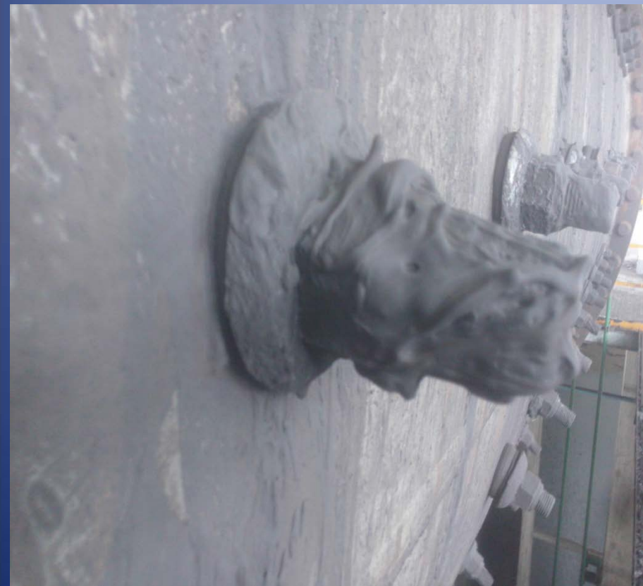
改造前：筒体螺栓漏浆严重
