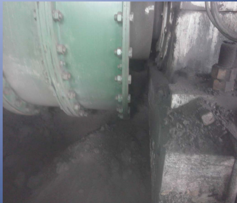
改造前：煤粉堆积影响离合器运行
