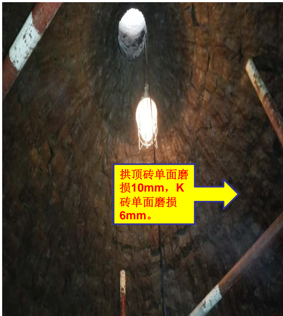
2014年10月 C炉拱顶砖高温运行100天后烧蚀较严重
