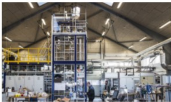
Topsoe公司位于丹麦富勒姆SOE+甲烷化耦合装置
