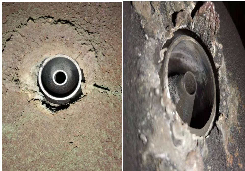
烧嘴室积渣实物图
