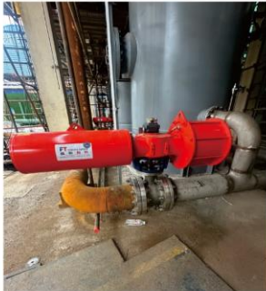
奥科供晋巨合成-分子筛工况 高温耐磨半球切断阀-现场照片
