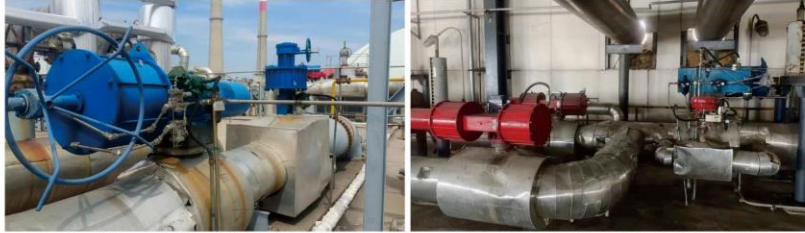
目前: 煤化工-变换基本用切断蝶阀作为切断作用 易引起安全隐患
