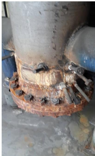
某公司角阀使用三个月文丘里下的三通使用情况
