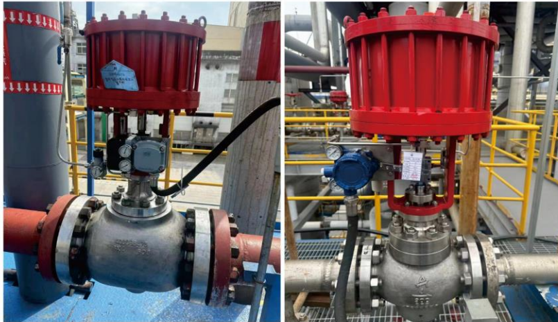
奥科改造晋巨放空阀-晋化炉合成工况现场照片
