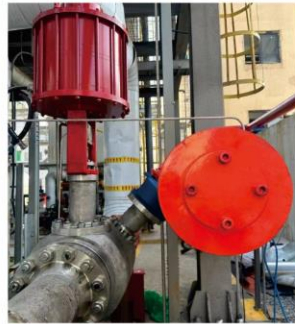
在晋巨合成甲醇洗-分子筛液氮洗工况 高低温交替耐磨双阻断阀-现场照片
